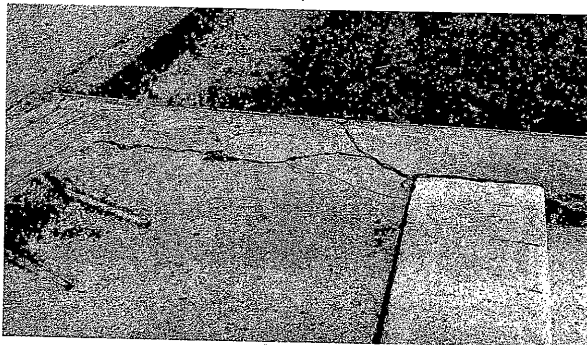
Покрытие из бетона мозаичного состава растрескалась, имеет неприглядный вид.
