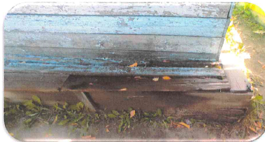
Состояние веранды на прогулочном участке группы № 7
