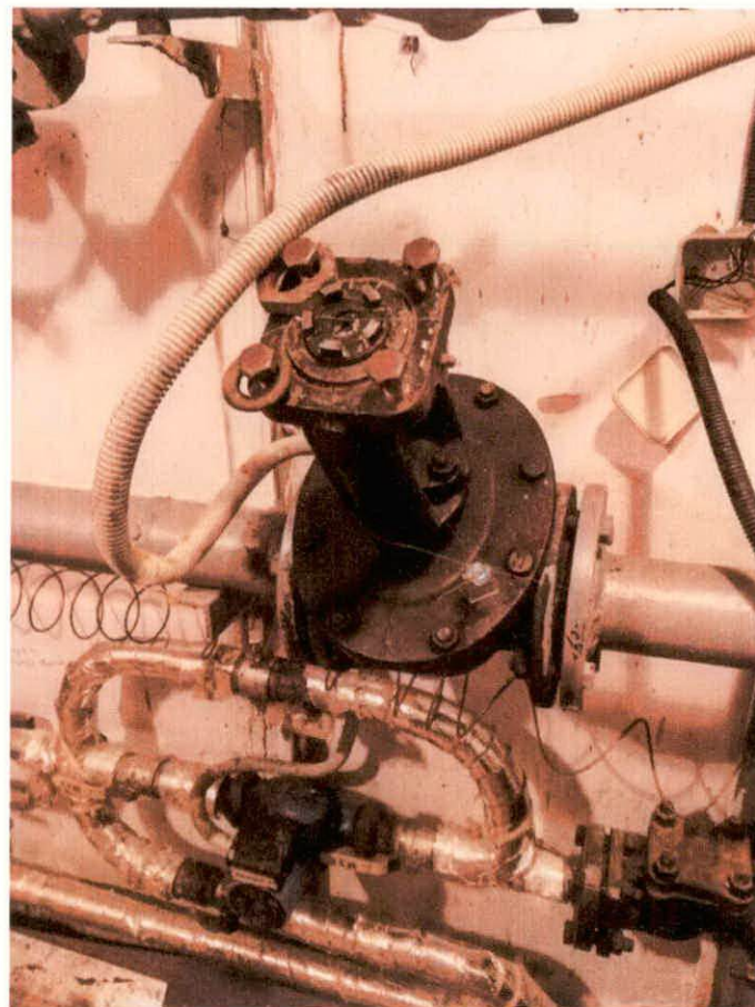
Место установки задвижки в рамке ввода (помещение 86 по экспликации к поэтажному плану нежилого здания МАДОУ № 21)
